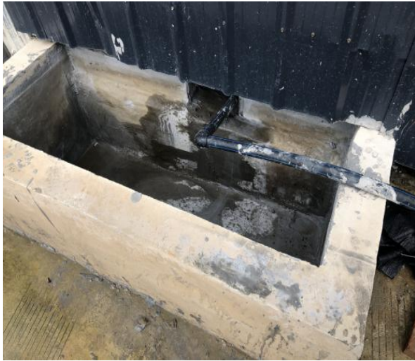
室外污水检查井
