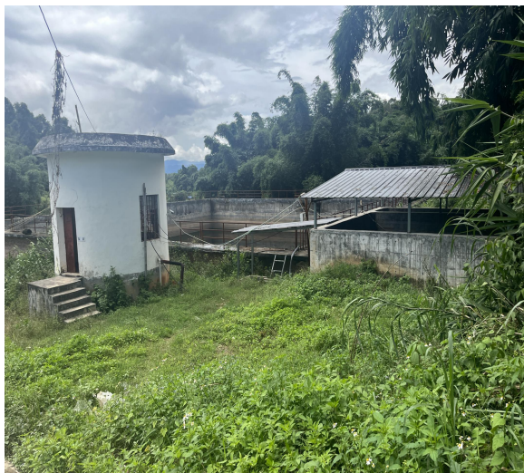
调节池、回水泵房、浓缩池、清水池
