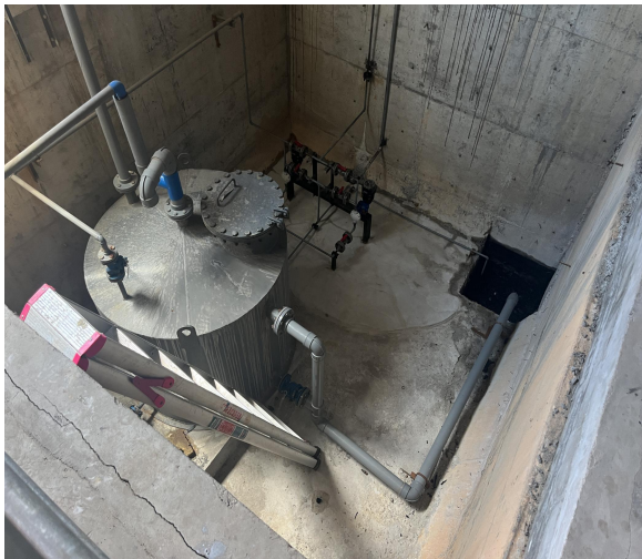
硫酸罐事故应急设施
