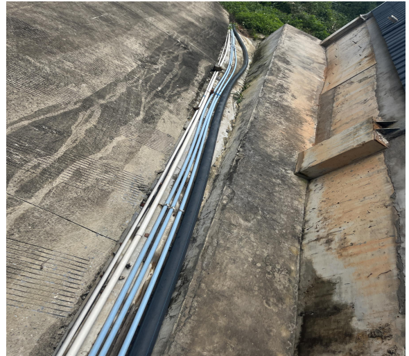
冲洗废水收集管道
